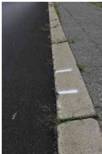
Obrubník v Železničářské ulici poškozený tankovým pásem (foto M. Kalíšek, 2017)
